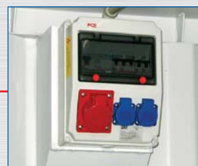
rozvodní skříň se zabudovanými zásuvkami
